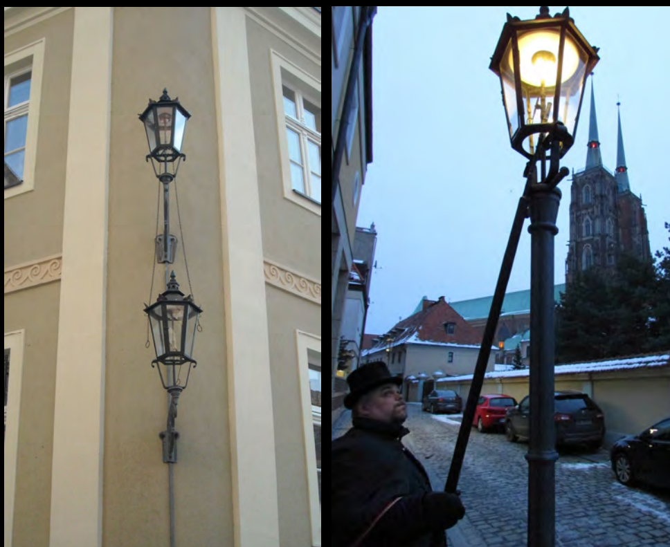
Links: Zwei Wandkonsolen mit Gasleuchten; rechts der Laternenanzünder bei seiner Arbeit. Bilder Sammlung ProGaslicht
