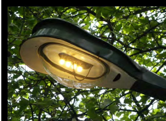
Vierflammige Gasreihenleuchte auf der Hansaallee (inzwischen entfernt)
