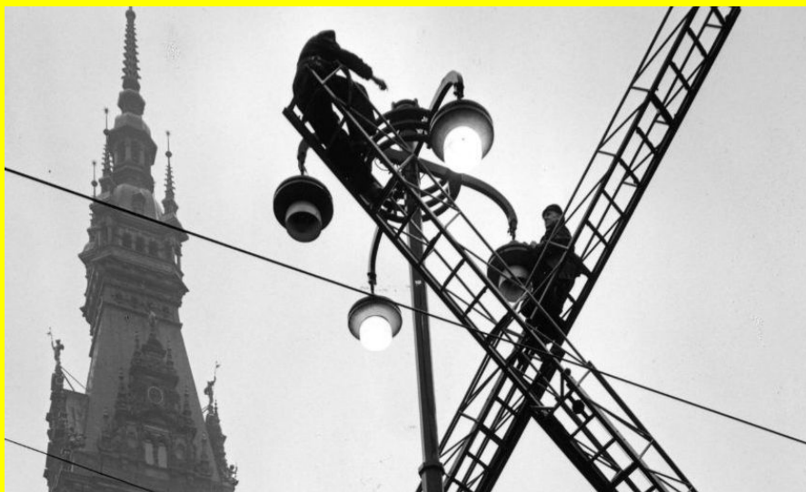
Wartung eines vierarmigen elektrisch betriebenen Kandelabers (1950er Jahre). Bildquelle: unbekannt/Slg. PGL
