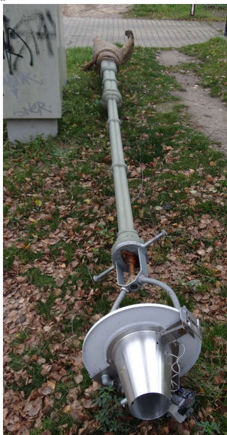
Aus dem Boden gerissen, dabei wurde der Erdbock zerstört. Die Gasleuchte war noch relativ neu, wie man deutlich sieht. Bild: Joachim Raetzer
