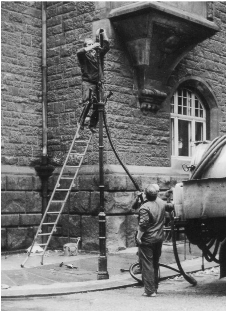
Im Jahr 1988 wird die Aufstellung dreier Gasleuchten auf dem Thomaskirchhof in Leipzigs Innenstadt vorbereitet. Dies geschieht hier durch Wasserziehen aus der Gasleitung. Bild: Manfred Stopp
