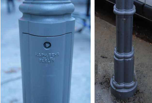
Die Fa. Behr aus Berlin-Weißensee ist bei der Lieferung von Bündelpfeilmasten für Elektrobetrieb groß im Geschäft; rechts die in einen Gasmast hineingebrannte Mastklappe für den Einsatz als Elektroleuchte. Bilder: Slg. PGL
