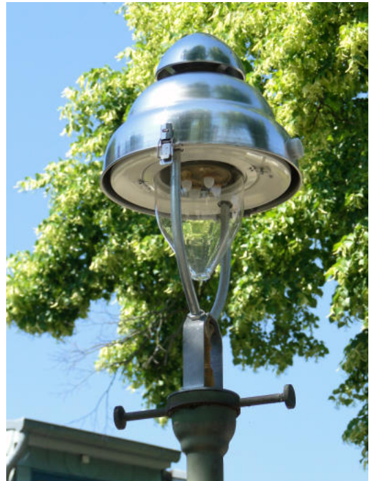
Trotz der Abrisspläne werden auch einige Gasleuchten komplett neu ausgestattet wie hier in Lichtenrade, Bild: Joachim Raetzer
