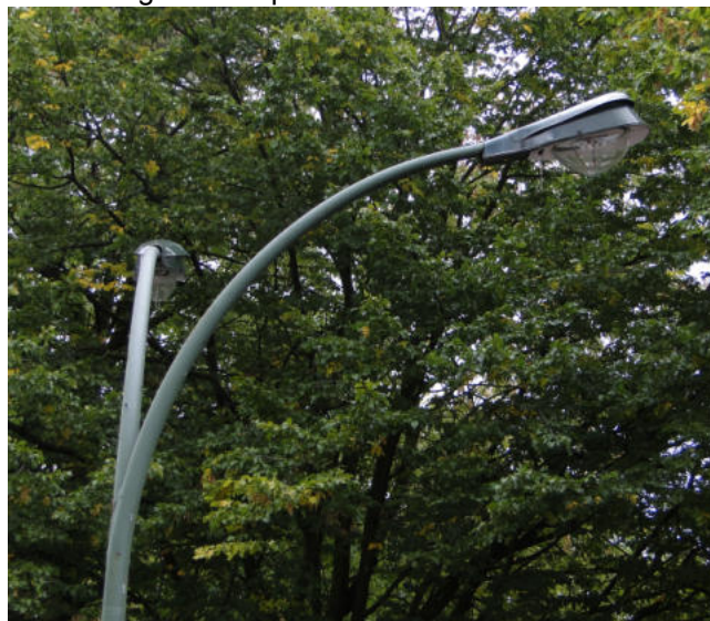
Am Richard-Strauß-Platz befindet sich dieses Einzelstück: Eine Doppel-Gasreihenleuchte, hier wurde offenbar ein zweiter Bogenausleger angeschweißt. Bild: Bettina Grimm
