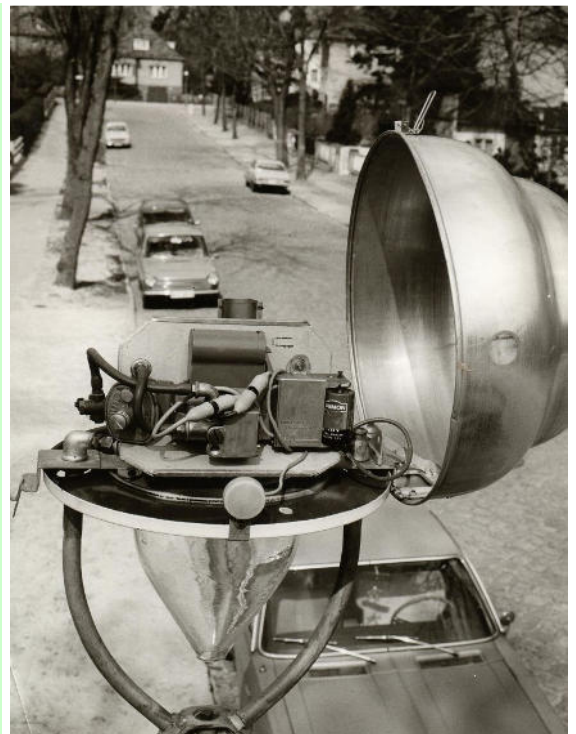
Einbau eines Kalin-Schaltgerätes in eine BAMAG-U7-Aufsatzleuchte im April 1975 in Berlin-Hermsdorf, Hillmannstraße, Bild: Slg. PGL
