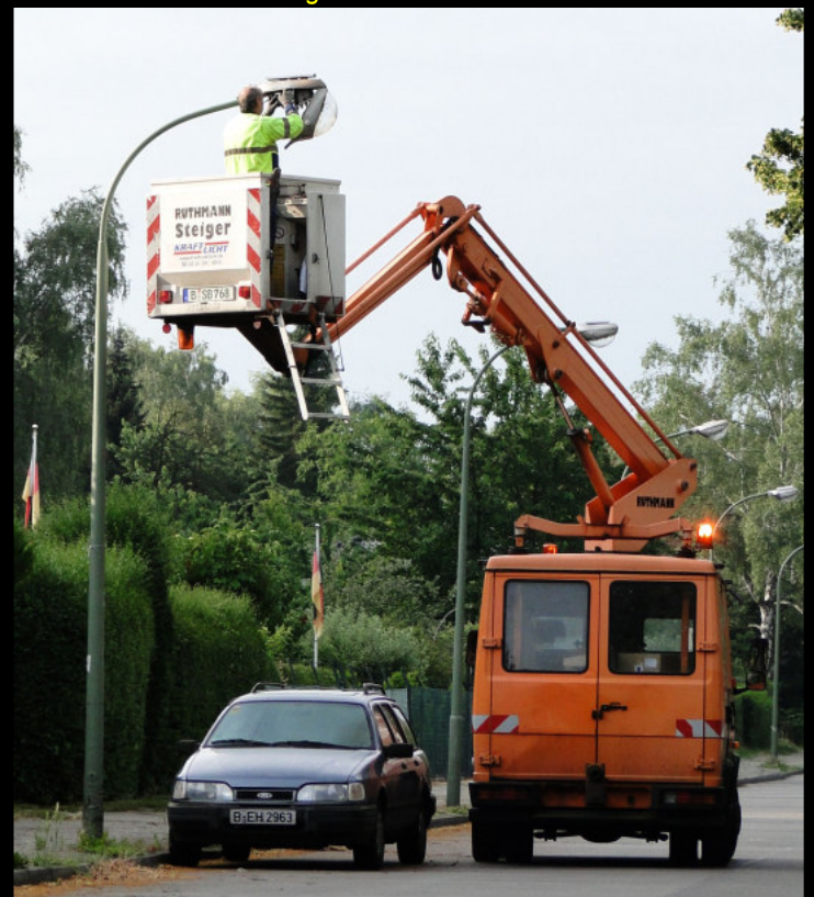
Unten: Gasreihenleuchten bei der Inspektion vor Ort, hier in der Wünsdorfer Straße in Lichtenrade. Diese Gasleuchten wurden inzwischen abgerissen. Bilder: Joachim Raetzer
