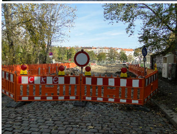
Bilder oben: Die Torgauer Straße mit dem Sammelsorium aus angestammter Gas- und zusätzlich installierter Elektrobeleuchtung. Inzwischen sind die Gebäude abgerissen, die Straße aufgedigelt, alle Gasleuchten und fast alle E-Leuchten wurden demontiert.
