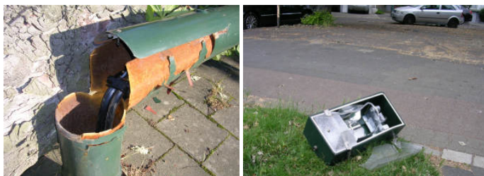
Ganz oben: Abgebrochener Elektrolichtmast in der Innenstadt.
