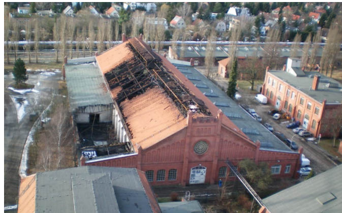
Die historische GASAG-Halle nach dem Brand, Bild: Sg. Heise
