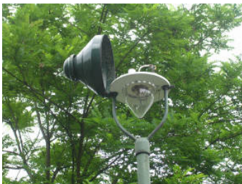
Geöffnete Gasleuchte in der Erwin-von-Witzleben-Straße
