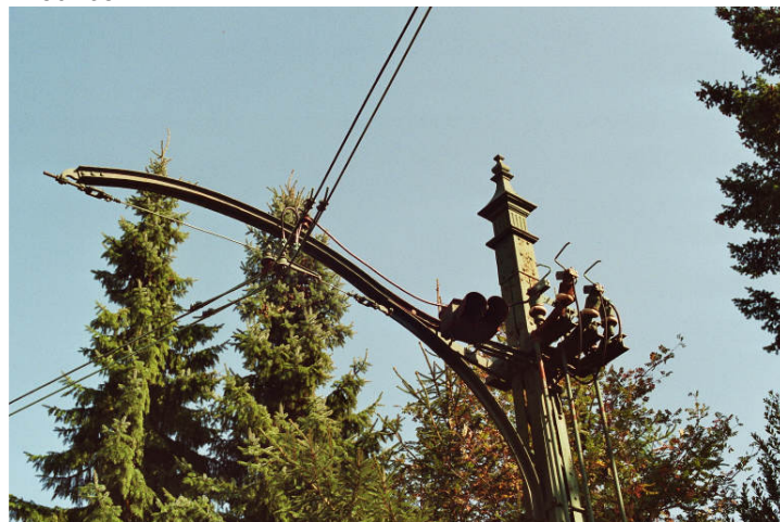
Als Fahrleitungsmaste noch schön sein mussten: Vierkantiger Gittermast mit gusseiserner, pagodenartiger Zierspitze mit einem schwungvollen Ausleger zur Befestigung des Fahrdrabtes. Spannend sieht auch die Strominstallation aus. Am Fuß des Mastes befand sich ein Schaltkasten. Wenn Heinz Johann dort den Hebel umlegte, floss Strom in die Leitung und seine Straßenbahn konnte fahren. Bild: Bettina Grimm
