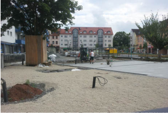
Bauarbeiten fast beendet. Das Ergebnis: Furchtbar! Bild: Wikipedia
