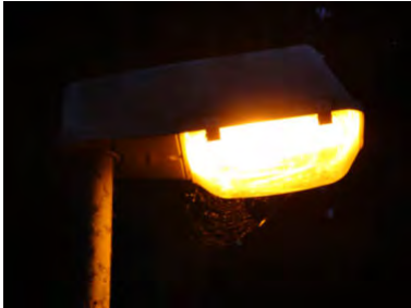
Scheußlicher geht's nicht: Zwischen den Gaslichtern finden sich immer wieder solche unpassenden Elektrofunzeln, obendrein total verschmutzt. Bild: Bettina Grimm
