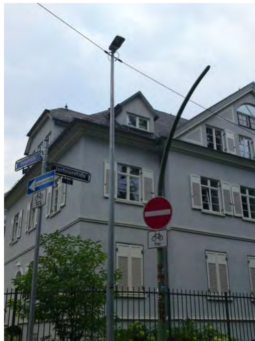
Dieses Strom-Provisorium dauert nun schon ein Jahr. Daneben die enthauptete Gas-Reihenleuchte.
