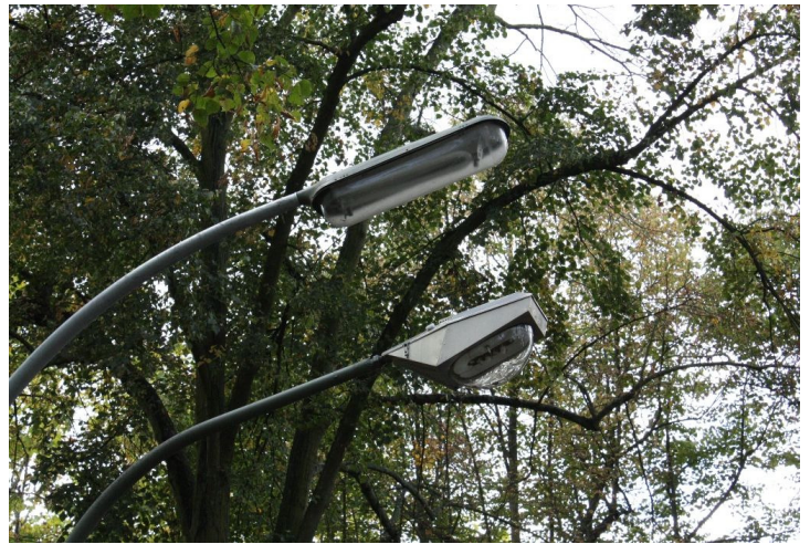
Völlig irre: In der Horstwalderstraße 9 wird eine moderne Gas-Reihenleuchte von 2005 (unten) durch eine veraltete Stromleuchte aus den sechziger Jahren ersetzt. Foto: Bettina Grimm
