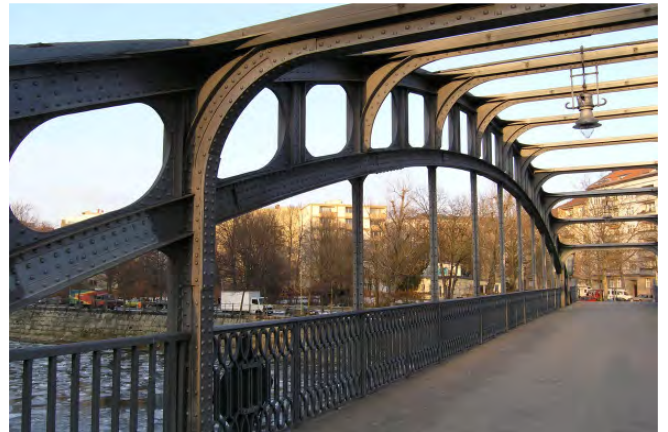
Auf der Brücke sind zwei Gas-Hängeleuchten montiert, Blick nach Norden in Richtung Moabit: Foto: Inge Kanakaris-Wirtl
