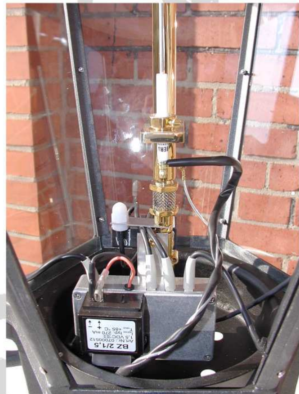
Modernes Schaltgerät einer Gasleuchte. Bild: Sammlung ProGaslicht
